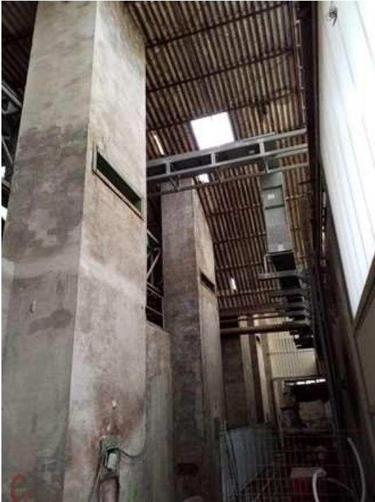
FOTO 1 CAMINI INTERNO CAPANNONE DEL FORNO ESSICCAZIONE
