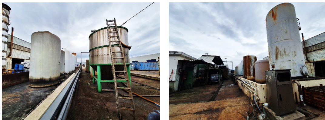
FIGURA 1, FIGURA 2: IMPIANTO DI TRATTAMENTO ACQUE REFLUE
