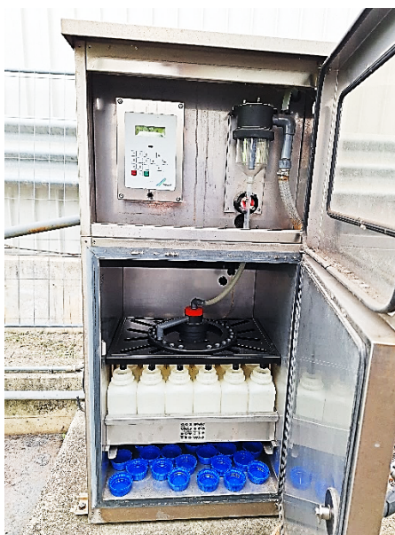
FIGURA 3 AUTOCAMPIONATORE DELLA DITTA INSTALLATO ALLO SCARICO PARZIALE S1
